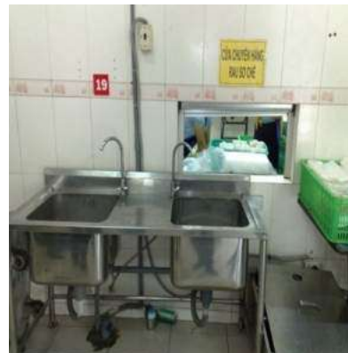
Hình 4.3.85. Bể nước rửa
